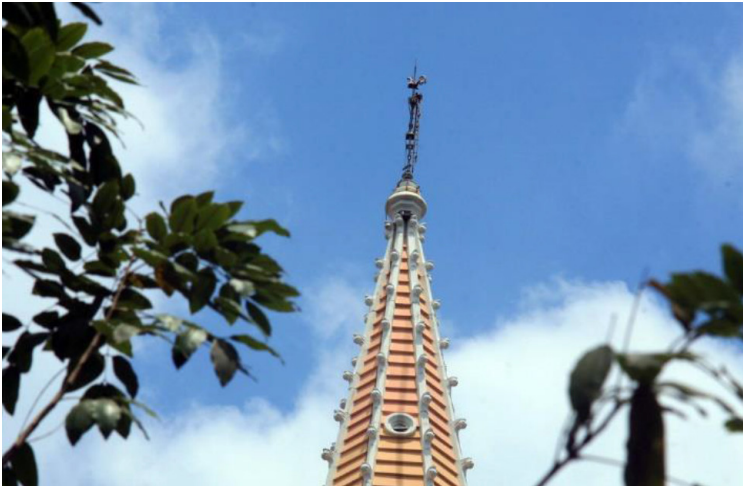
Con gà trên đỉnh tháp chuông nhà thờ Chợ Đũi. Nguồn: Tachcaphe.com.
